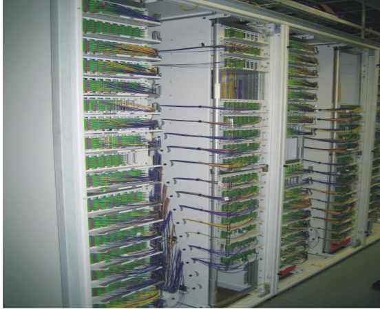
Slika 5. Izvedba centralnog optičkog razdjelnika (ODF)
